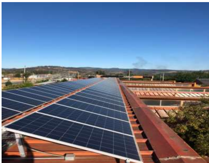
Paneles solares en el CESFAM Ricardo Valdés
