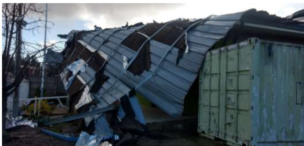
Destrucción Cecof Rosita O'Higgins
